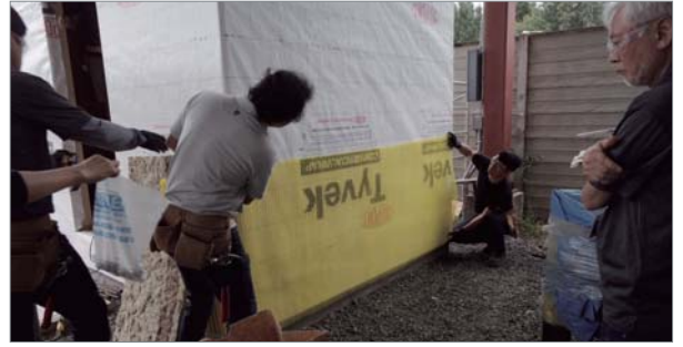
이중 스티드벽에는 일반적인 레인스크린이 아닌 흡실리커를 설치했다. 건물 하부를 통해 벌레들이 들어오지 못하도록 방충망을 설치한다.
